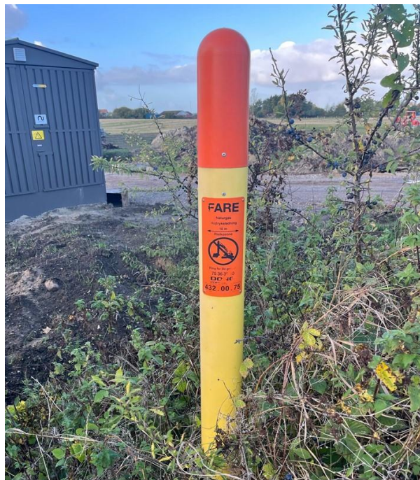
Figur 5: Billede af mærkestander, der markerer gasledning
