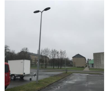
LYSMAST PÅ P-PLADS (100%)
