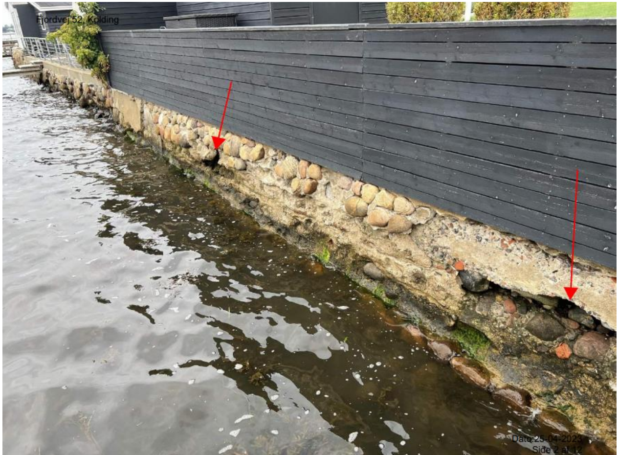
Billedbilag 1. Huller i eksisterende kystsikring, hvor beton er eroderet væk, og kampesten har løsrevet sig.
