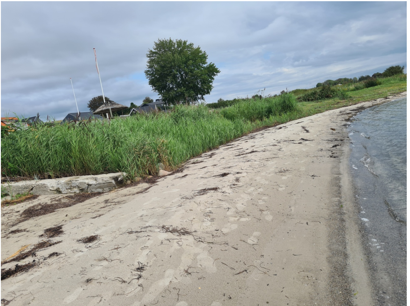
Selv om det yderste stykke af den gamle betonmur mellem Kystvej 5 og 5A er brækket af, ses muren stadig.
