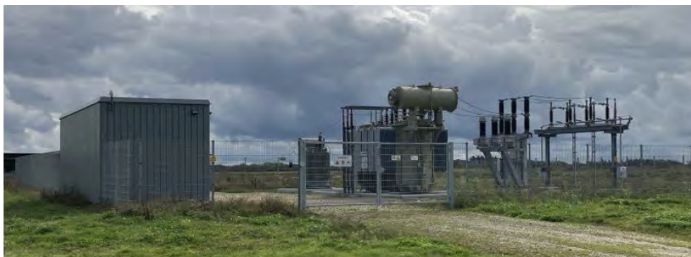
Figur 1-6 Eksempel på transformer og teknikbygning.
