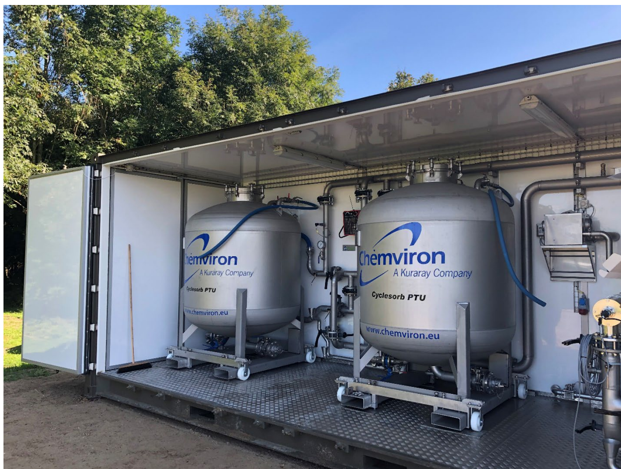
Figur 1: Billedet viser en avanceret rensecontainer med to filteranlæg m.v. som ønskes opstillet på kildepladserne ved Søndre Vandværk og Trudsbro Vandværk til rensning af pesticidnedbrydningsstoffet desphenyl chloridazon (DPC) i 3 boringer.
