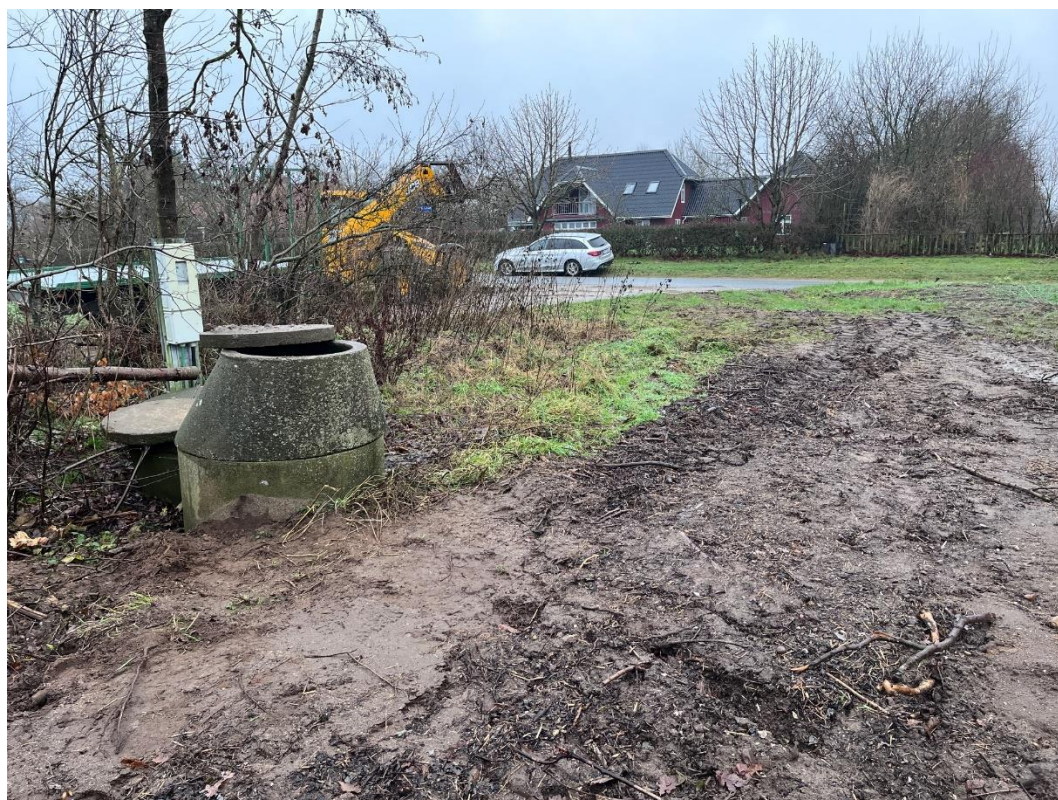
Figur 2 Indvindingsanlægget. Anlægget består af to tørbrønde til hhv. boring DGU nr. 124.390 og til en pumpe.
