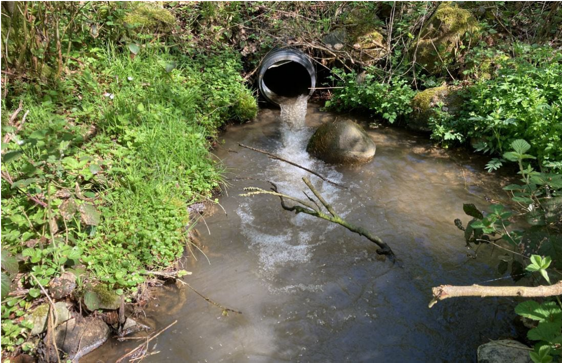
Figur 2. Fald ved rørudløb, februar 2024. Tæt ved røret blev der set ørred (1 års).
