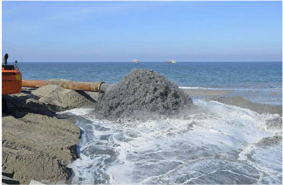
Figur 2.3: Eksempel på sandfodring med flydeslange (sandfodring ved Agger). I baggrunden ses skibene, der kommer med sand.
