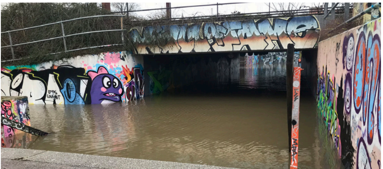
Oversvømmelse i jernbanetunnel parkhustorvet, 2020
